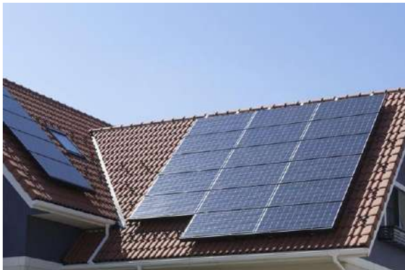
Cellules polycristallines // Maison&Travaux
