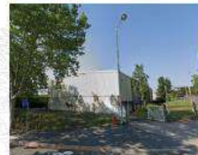
Les façades aveugles et dégradées du Gymnase J. Prévert
